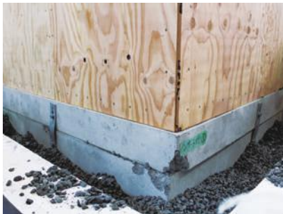
無対策実験 日立波で崩れた基礎
