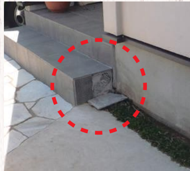
剥がれた玄関タイル
